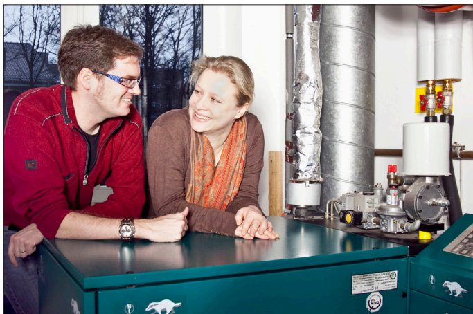
txn. Wärme und Strom lassen sich mit einer Mikro-KWK-Anlage im eigenen Heizungsraum produzieren. Foto: SenerTec/txn
